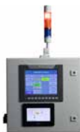
Peletizador, báscula y detector de \text{CO}_2 pueden ser controlado por medio de un control remote
